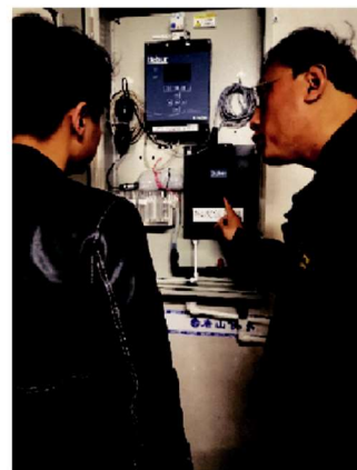
唐山市二供现场
